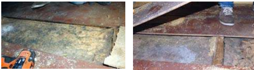
2. attēls. Kokskaidu vates siltuma izolācija bēniņos ar pelējumu pēc to nosedzošā saplākšņa noņemšanas.
