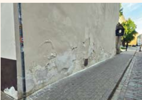
Ēkas siena ar kapilārā mitruma bojājumiem.
