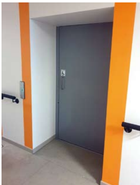
3. attēls. Aprūtināta piekļuve pie vertikālās cēlējplatformas šahtas durvju roktura (sienas izbīdījums 250 mm vietā ir 600 mm). Ar izsaukuma pogu, ko nedrīkst uzstādīt tieši pie šahtas durvīm, šeit viss ir kārtībā.
